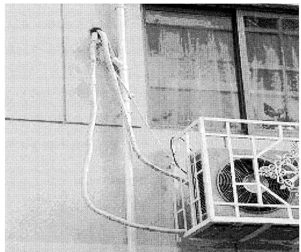
図4. 壁面に取り付けられた室外機
